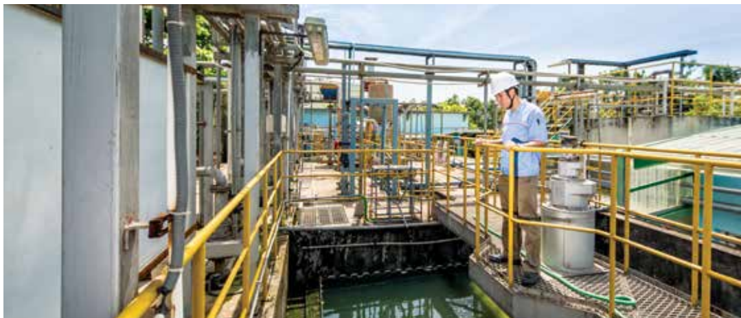
Hệ thống xử lý nước thải của TMV TMV's wastewater treatment system
